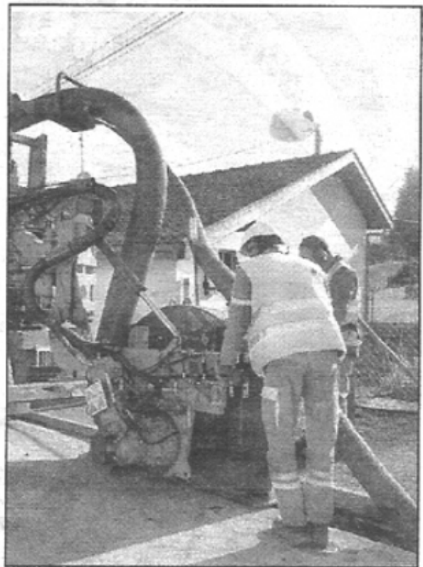
La commune de Louvemont est équipée de la fibre optique.
